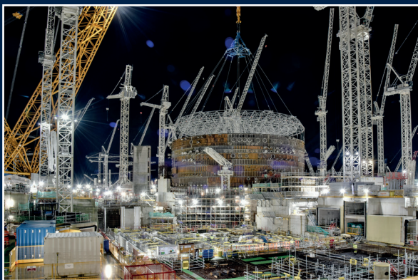
▲ AVANCEMENT DU CHANTIER HPC POSE DU LINER D'ENCEINTE © EDF HINKLEY POINT C MEDIA TEAM
